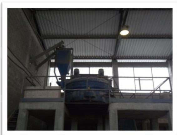
Slika proizvodnje-mješalica za beton
